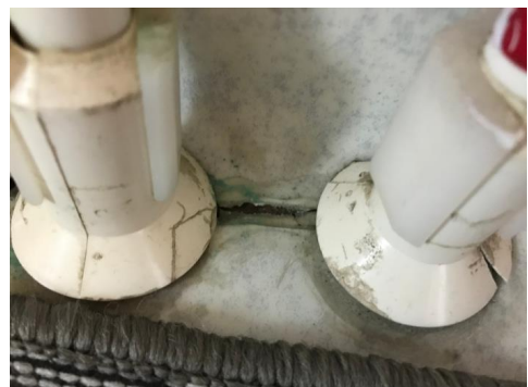
Sprekk i belegg
