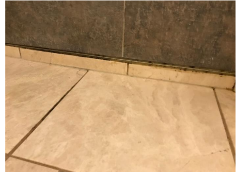
Svertesopp ved gulv i dusjsone.
