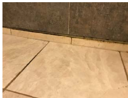
Svertesopp ved gulv i dusjsone.
