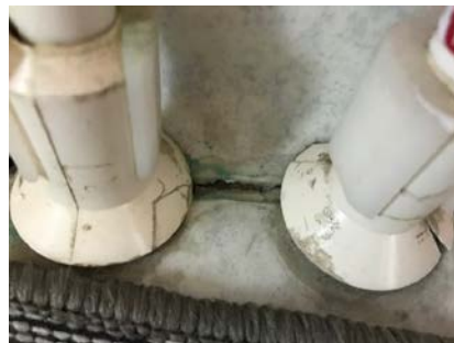
Sprekk i belegg
