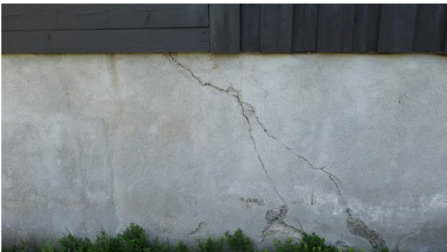
Sprekk i grunnmur mellom hytta og terrasse.
