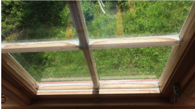
Vinduene trenger vedlikehold.
