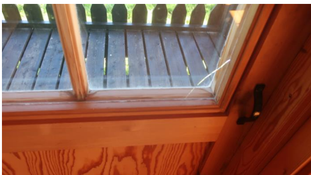
Sprekk i rute i terrassedør.
