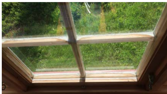
Vinduene trenger vedlikehold.
