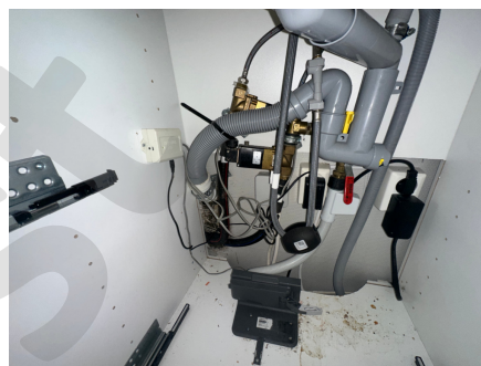
Rørplegg i kjøkkenbenk
