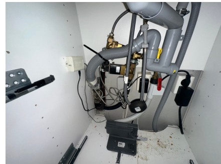
Røropplegg i kjøkkenbenk
