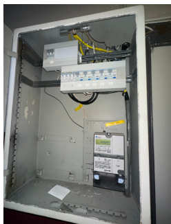
Sikringsskap med automatsikringer.
