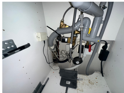
Røropplegg i kjøkkenbenk
