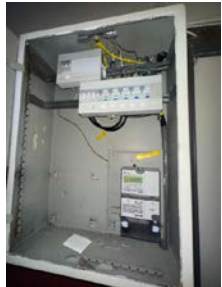
Sikringsskap med automatsikringer.
