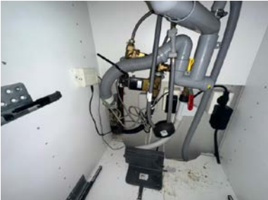
Rørøpplagg i kjøkkenbenk
