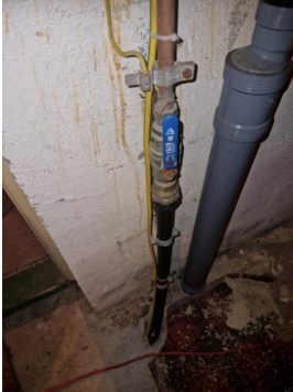
PEL inntaksledning. Avløpsrør i plast.
