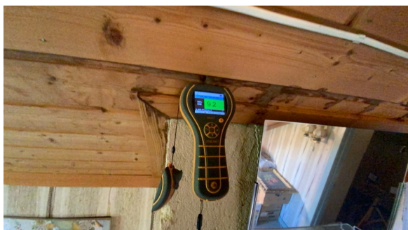
Synlig fuktmerker rundt pipe innvendig.
