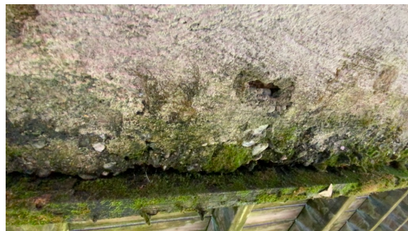
Skade i betong etter rust fra armering.
