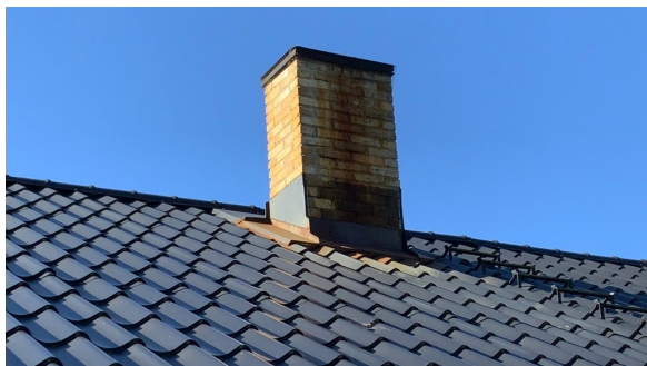
Rust rundt beslag.
