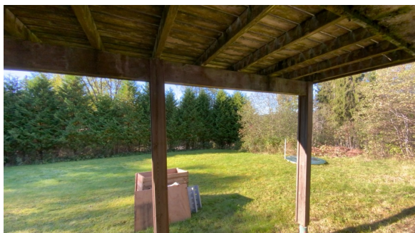
Noe skjevhet i søyler
