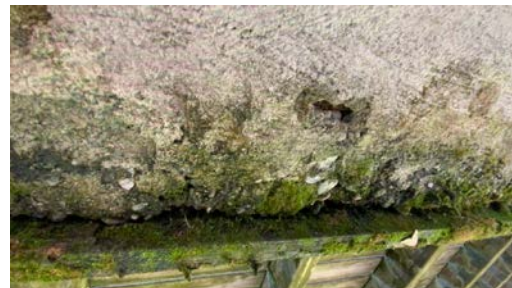
Skade i betong etter rust fra armering.
