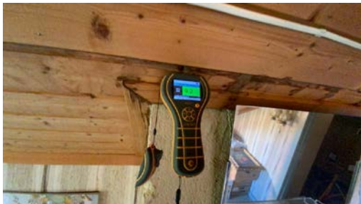
Synlig fuktmerker rundt pipe innvendig.
