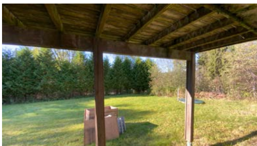
Noe skjevhet i søyler
