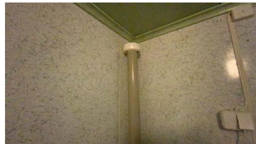
Luftingen av avløpsrør er avsluttet med Durgoventil på vaskerom i 1 etasje.
