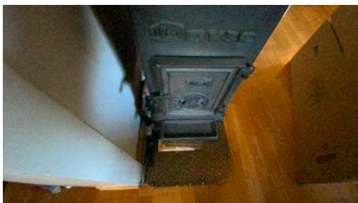
Plate under etasjeovn ligger under 30 cm fra åpning på vedluke.
