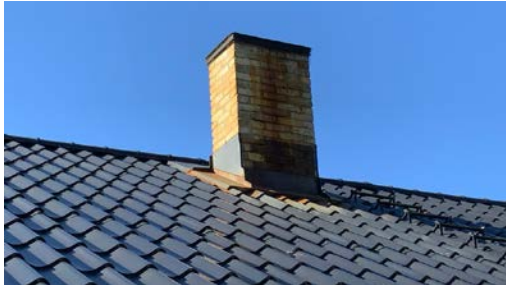
Rust rundt beslag.
