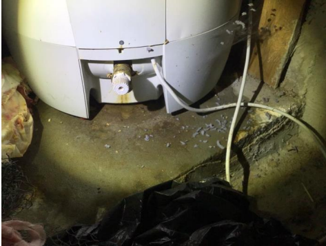
Vann under varmtvannstanken
