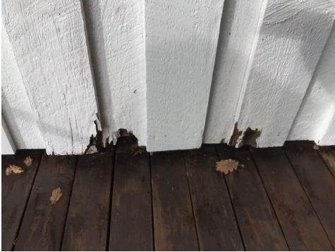
Råteskader i nedkant kledning
