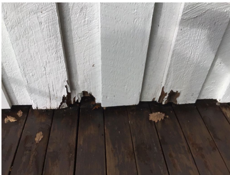
Råteskader i nedkant kledning
