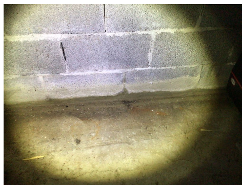
Fukt langs yttervegg mot nord
