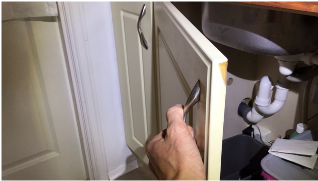
Bildet viser kjøkkenfronter med delaminering.
