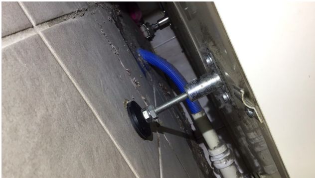
Bildet viser sluket under dusjkabinettet.
