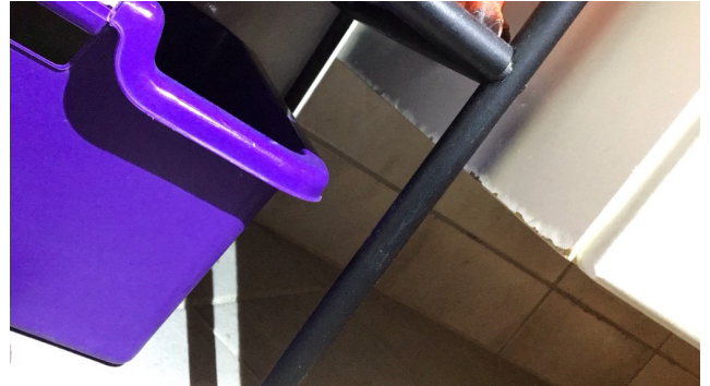
Bildet viser svelling på servantskapet.
