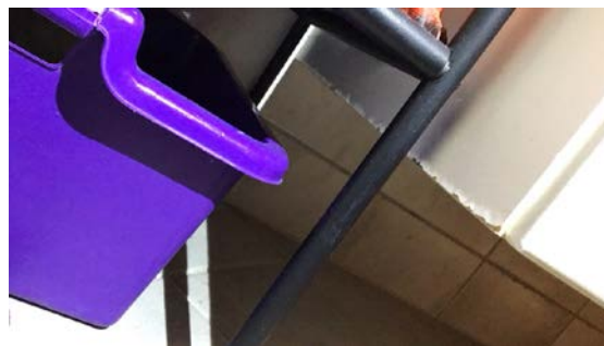
Bildet viser svelling på servantskapet.
