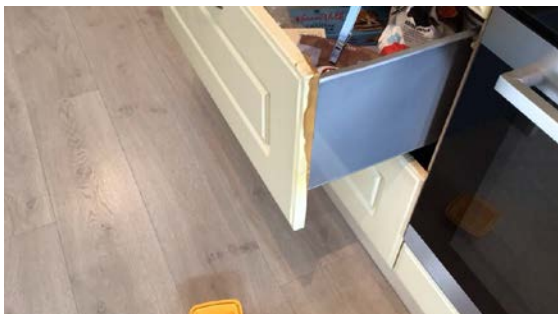
Bildet viser kjøkkenfronter med delaminering.
