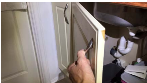
Bildet viser kjøkkenfronter med delaminering.
