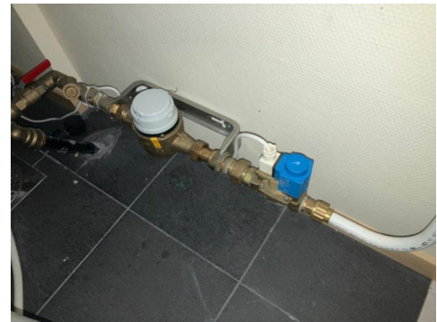
Vannmåler og stoppekrane
