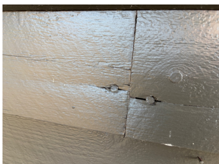
Stedvis sprekker i kledningen.
