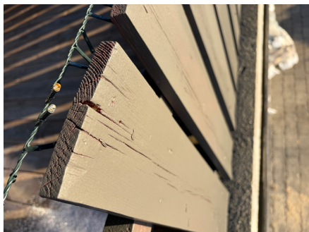
Synlige slitasjer på rekkverksbord.
