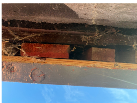
Stedvis manglende musesperre.
