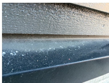
Stedvis manglende lufting.
