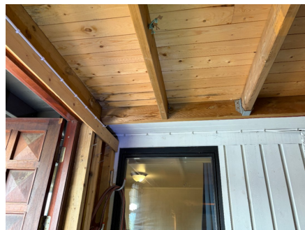
Noe synlig spor etter lekkasje.
