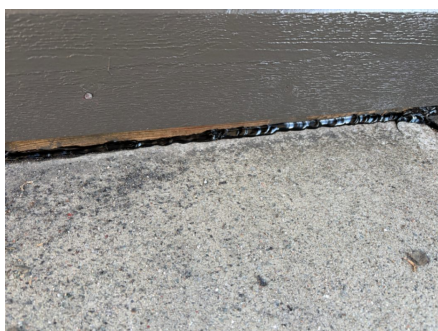
Det er kun fuget med asfaltlim i overgang.
