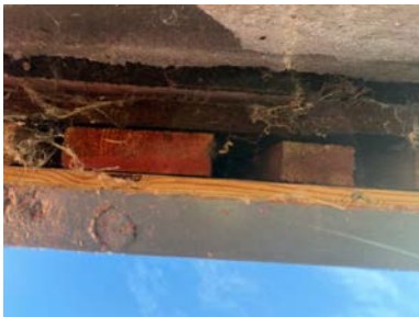
Stedvis manglende musesperre.
