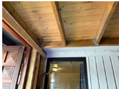
Noe synlig spor etter lekkasje.
