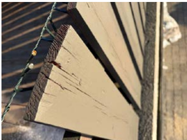
Synlige slitasjer på rekkverksbord.
