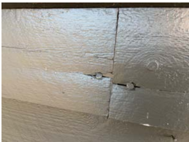
Stedvis sprekker i kledningen.
