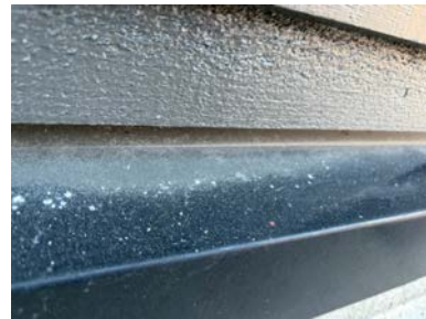
Stedvis manglende lufting.
