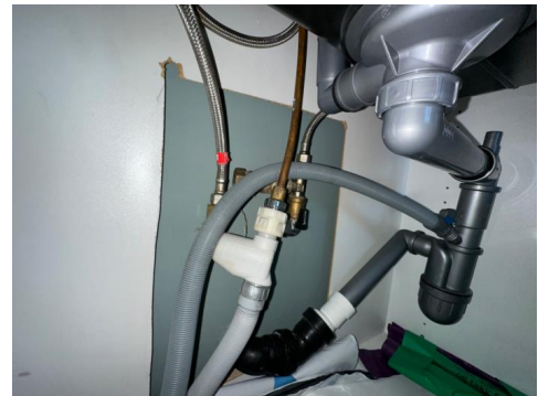
Rørpropp i kjøkkenbenk
