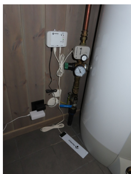
Vanninntak til bod- Hovedstoppekrane samt magnetventil med føler.
