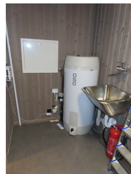
200 liters varmtvannsbereider inne i boden/teknisk rom.
