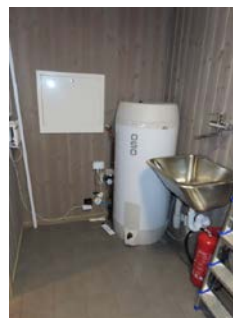
200 liters varmtvannsbereider inne i boden/teknisk rom.
