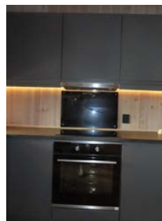
Kokeskone med avtrekksventilator og avtrekk ført ut gjennom vegg med utvendig blåfreventil.
