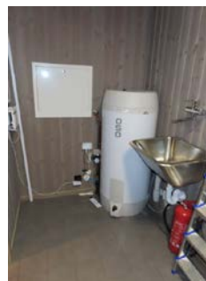
200 liters varmtvannsbereder inne i boden/teknisk rom.
