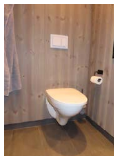
Veggmontert toalett med innebygd systerne.
