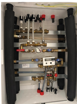
Samleskap med rørkurser og stoppekraner
