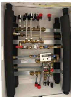
Samleskap med rørkurser og stoppekraner
