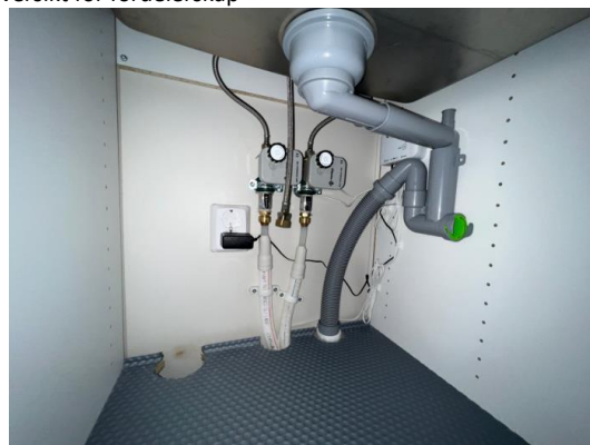
Vanntilførsel i kjøkkenbenk
