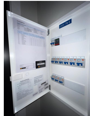
Sikringskap med automatsikringer.
