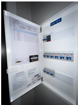
Sikringsskap med automatsikringer.
