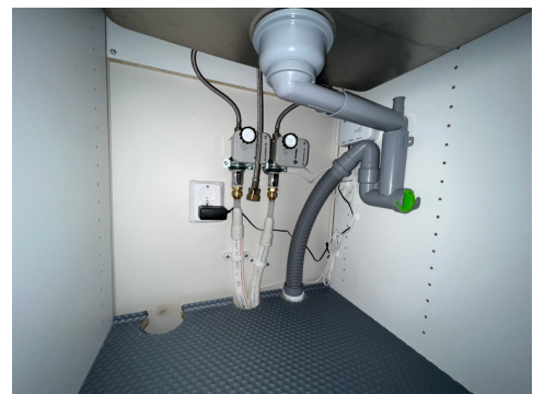
Vanntilførsel i kjøkkenbenk
