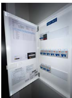
Sikringsskap med automatsikringer.
