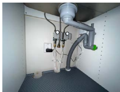
Vanntilførsel i kjøkkenbenk
