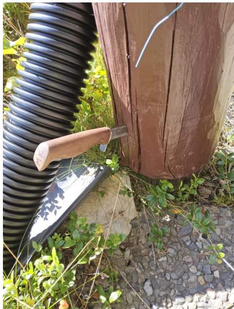
Bilde viser råteskadet søyle.
