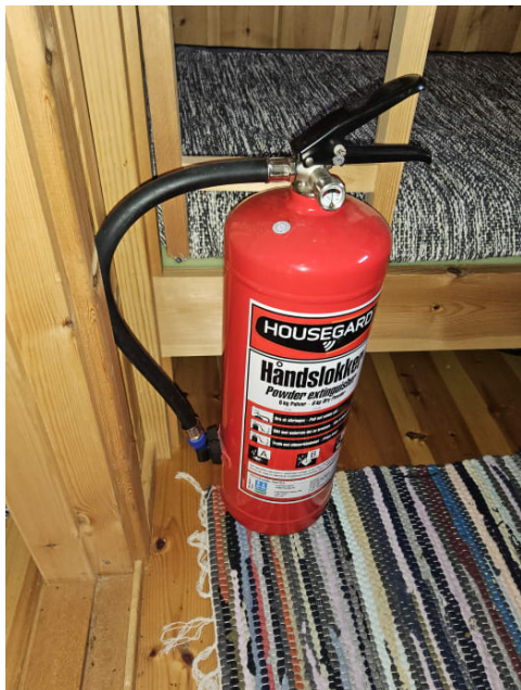
Bilde viser brannslukningsapparat.
