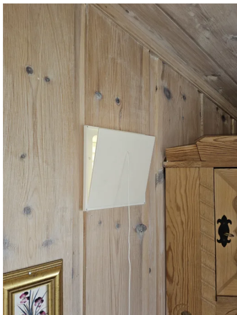
Bilde viser klaffventil på yttervegg.
