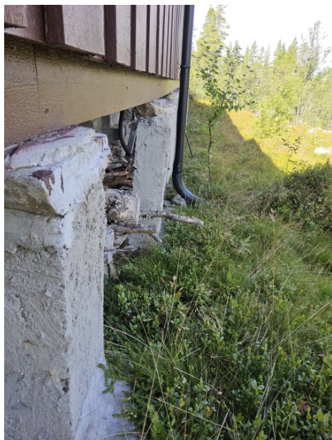
Bilde viser skjevhet i grunnmurssøyle.
