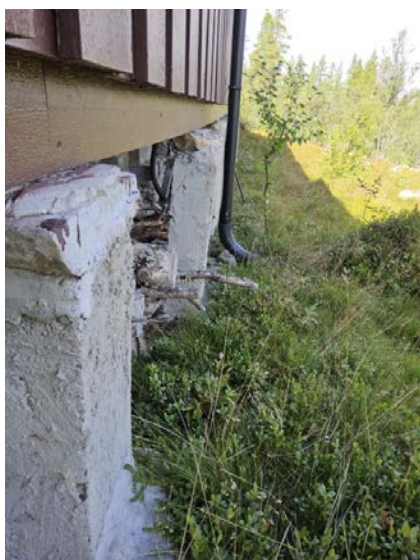
Bilde viser skjevhet i grunnmurssøyle.
