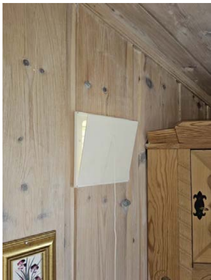
Bilde viser klaffventil på yttervegg.
