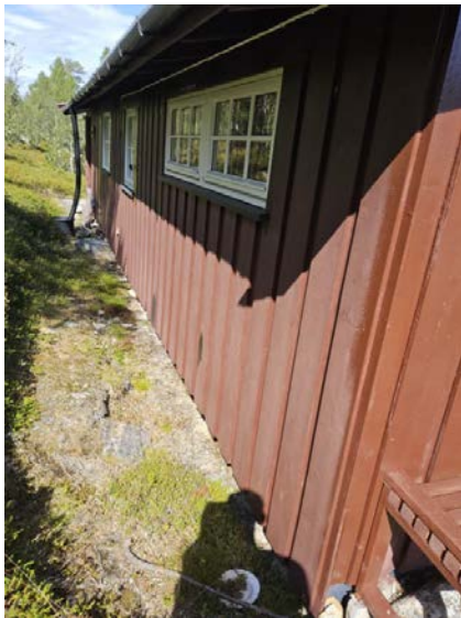
Bilde viser kledning ført ned mot terreng.
