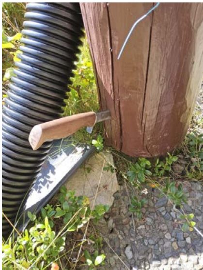
Bilde viser råteskadet søyle.
