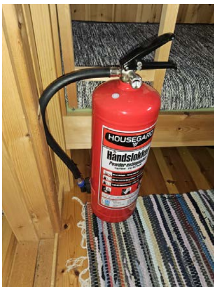
Bilde viser brannslukningsapparat.
