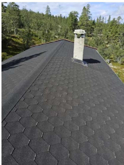
Bilde viser manglende takstige.
