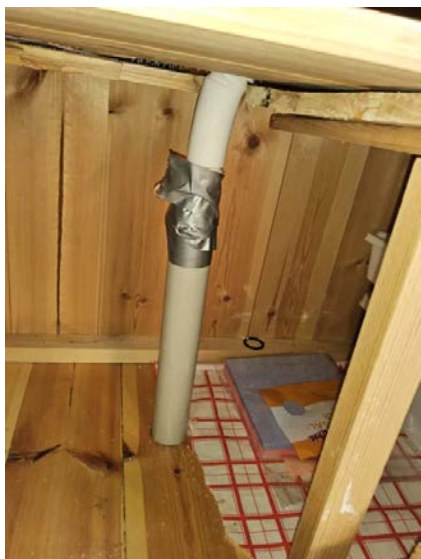
Bilde viser avløpsrør.
