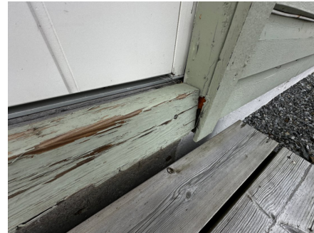
Dør mangler terskelbeslag
