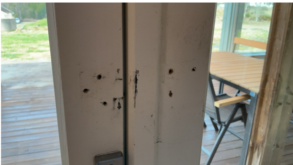
Skrue hull etter beslag i døren
