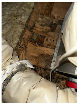
Fuktskjolder rundt ventilasjons aggregat
