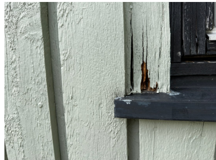
Råteskade i kledning
