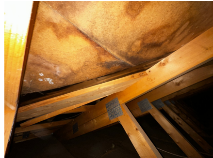
fuktskjolder i undertak
