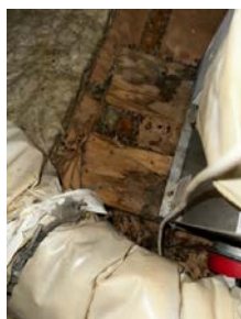
Fuktskjolder rundt ventilasjons aggregat
