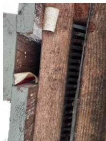
Stor åpning i kledning for at dyr kan komme inn bak kledning.
