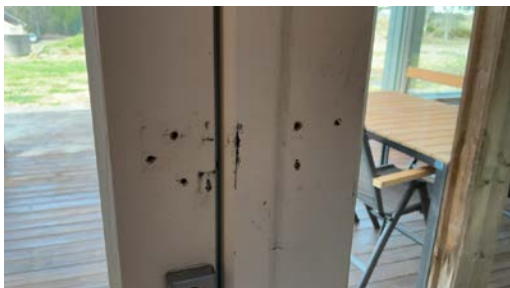
Skrue hull etter beslag i døren
