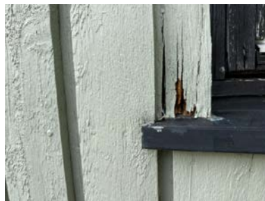
Råteskade i kledning
