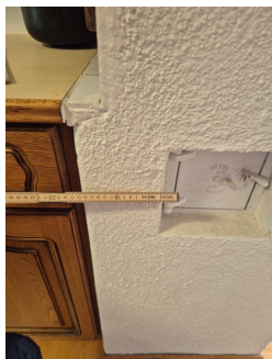
Brannbart materiale 15 cm fra sotluke og manglende plate på gulv.
