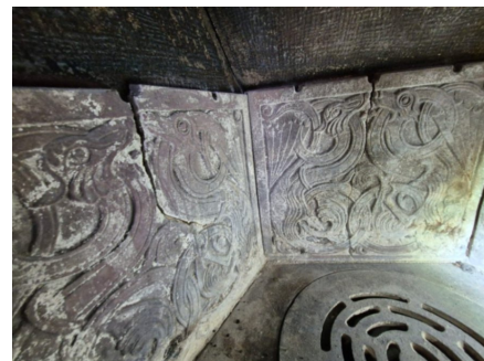
Sprekker i ildfast stein.
