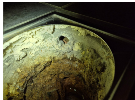
Støpejernsluk under vask, hull i siden.
