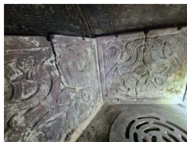
Sprekker i ildfast stein.
