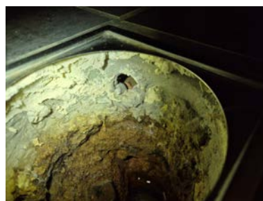
Støpejernssluk under vask, hull i siden.
