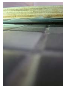
Ingen bunnskinne og synlig dampsperre.
