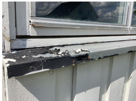
Eksempel på slitasje og avskaling på vannbrettbeslag.
