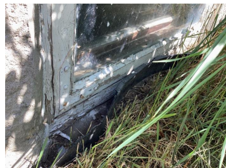
Kjellervindu med råte.
