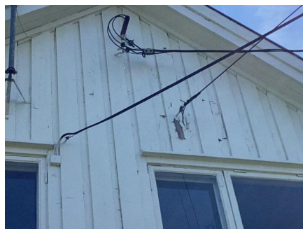
Eksempel på avskaling av maling.
