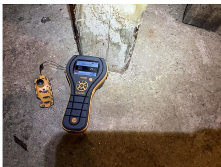
Fukttinnhold i kjellertrapp på over 20 vektprosent.
