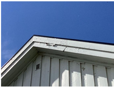
Eksempel på slitasje på vindskier.
