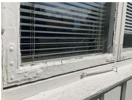
Eksempel på slitasje og avskaling av kitt.
