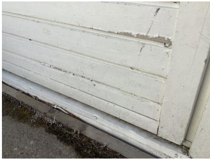
Eksempel på slitasje.
