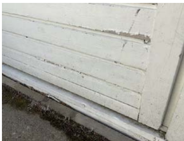
Eksempel på slitasje.
