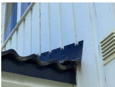
Beslag over entre er lagt utenpå fasadekledning.
