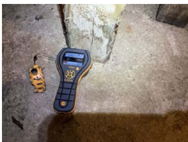
Fuktinnhold i kjellertrapp på over 20 vektprosent.
