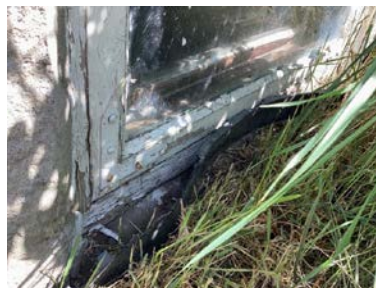
Kjellervindu med råte.
