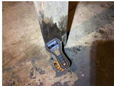
Fuktinnhold på ca. 25 vektprosent i søyle.
