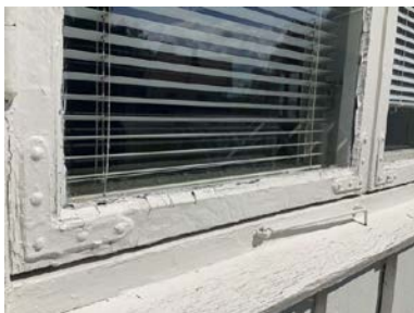
Eksempel på slitasje og avskaling av kitt.
