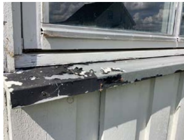
Eksempel på slitasje og avskaling på vannbrettbeslag.
