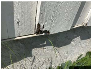
Eksempel på råteskade.
