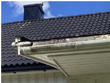
Eksempel på misfarging på takrenne og takfotbeslag.
