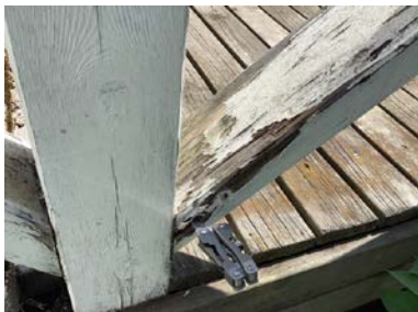
Eksempel på råte i rekkverk.
