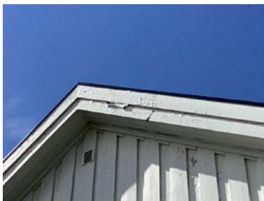
Eksempel på slitasje på vindskier.
