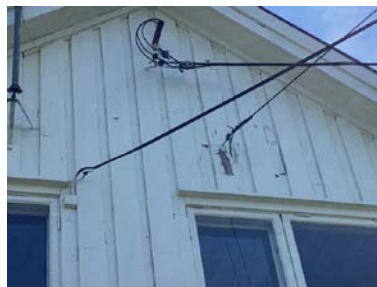
Eksempel på avskaling av maling.
