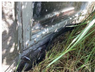
Kjellervindu med råte.
