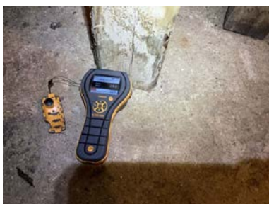
Fuktinnhold i kjellertrapp på over 20 vektprosent.
