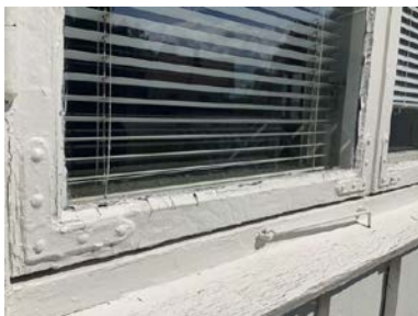
Eksempel på slitasje og avskaling av kitt.
