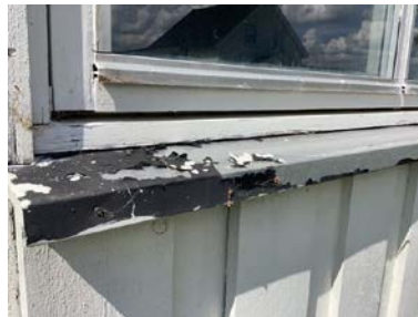
Eksempel på slitasje og avskaling på vannbrettbeslag.
