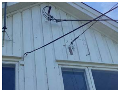
Eksempel på avskaling av maling.
