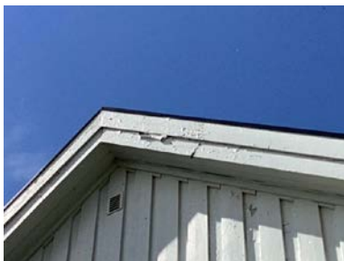
Eksempel på slitasje på vindskier.
