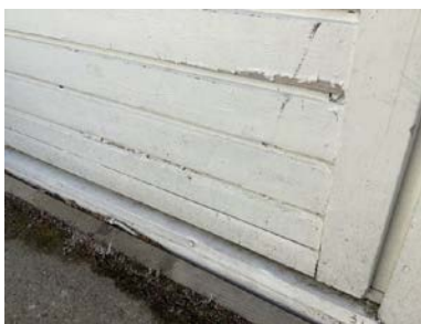
Eksempel på slitasje.
