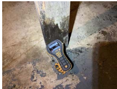
Fuktinnhold på ca. 25 vektprosent i søyle.
