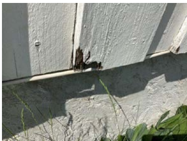
Eksempel på råteskade.
