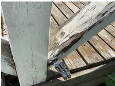
Eksempel på råte i rekkverk.
