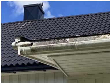
Eksempel på misfarging på takrenne og takfotbeslag.
