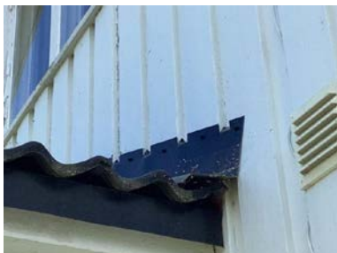
Beslag over entre er lagt utenpå fasadekledning.
