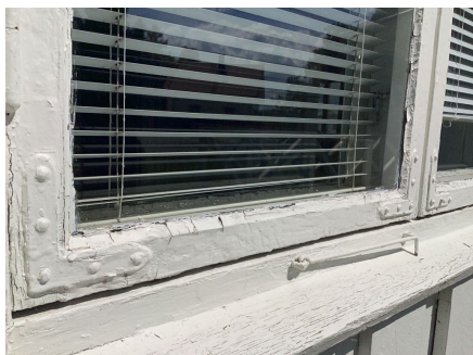
Eksempel på slitasje og avskaling av kitt.
