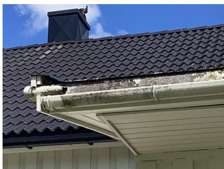
Eksempel på misfarging på takrenne og takfotbeslag.
