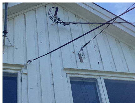
Eksempel på avskaling av maling.
