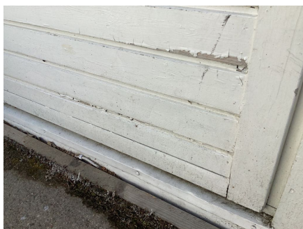
Eksempel på slitasje.
