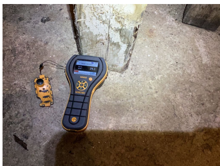
Fuktinnehold i kjellertrapp på over 20 vektprosent.
