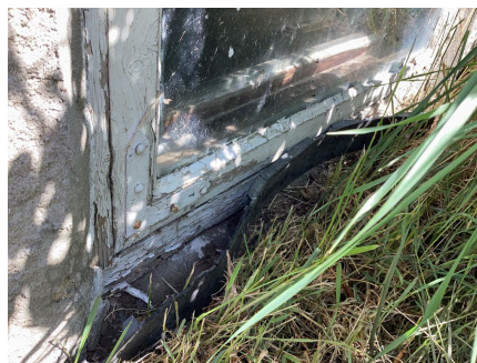
Kjellervindu med råte.
