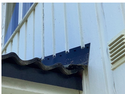
Beslag over entre er lagt utenpå fasadekledning.
