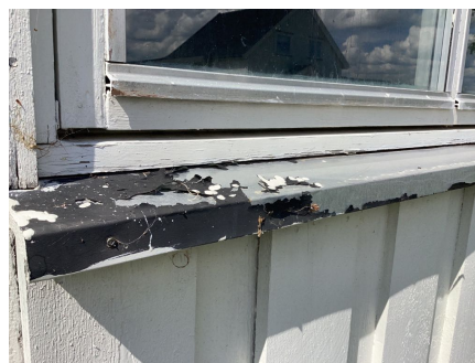
Eksempel på slitasje og avskaling på vannbrettbeslag.
