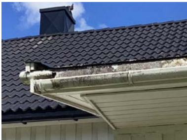
Eksempel på misfarging på takrenne og takfotbeslag.
