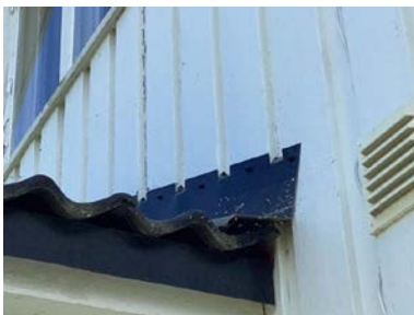
Beslag over entre er lagt utenpå fasadekledning.
