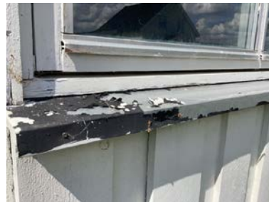
Eksempel på slitasje og avskaling på vannbrettbeslag.
