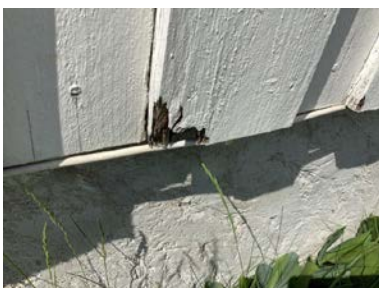
Eksempel på råteskade.
