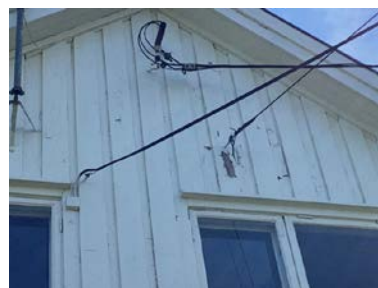
Eksempel på avskaling av maling.
