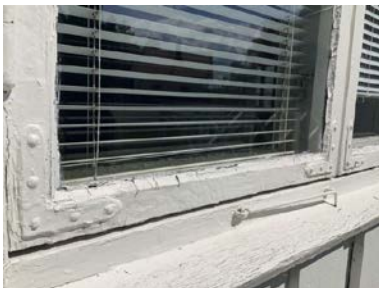
Eksempel på slitasje og avskaling av kitt.
