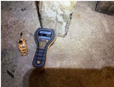
Fuktinnhold i kjellertrapp på over 20 vektprosent.
