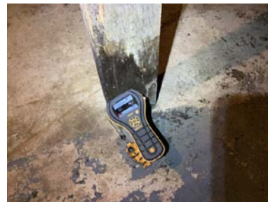
Fuktinnhold på ca. 25 vektprosent i søyle.
