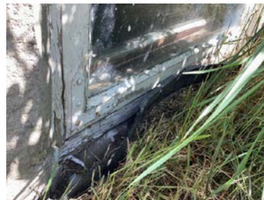
Kjellervindu med råte.
