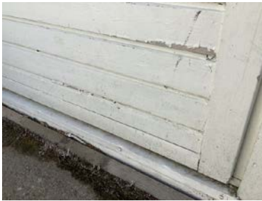
Eksempel på slitasje.
