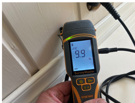
Fuktsøk i svill med pigg.
