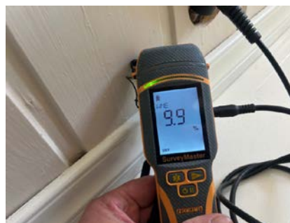
Fuktsøk i svill med pigg.
