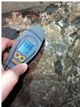
Yttermur har fukt og fuktutslag ved fuktmåletaking
