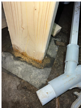
Stendere for børester til bjelker er satt på gulv i kjeller og preget av oppfukting
