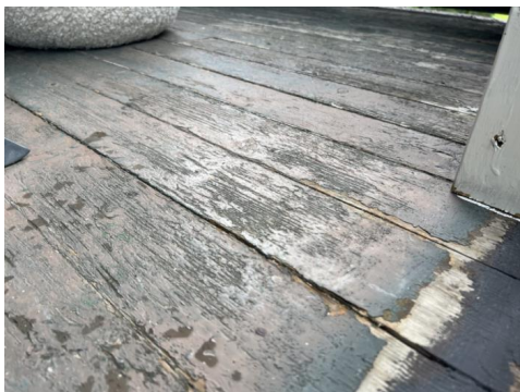
Tiltaksbehov av opprinnelig terrassegulv
