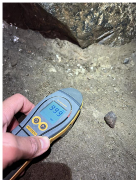
Gulv på grunn har fukt og fuktutslag ved fuktmåletaking
