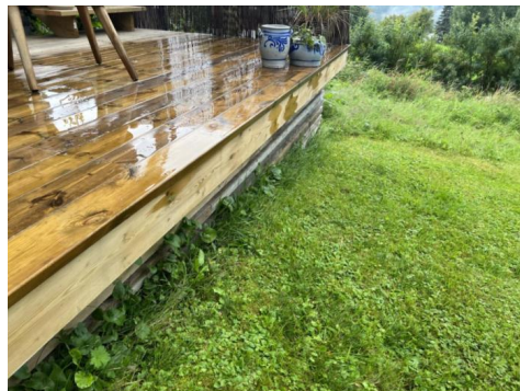
Manglende rekkverk på nyere terrasse som er over 50 cm til terreng
