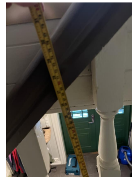
Rekkverkshøyde er under dagens krav
