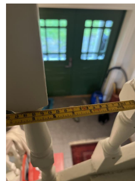
Åpning mellom spiler på rekkverk er over dagens krav
