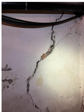
Sprekker og utgliding av mur, jordtrykk og utvendige masser bør undersøkes
