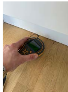
Tørre verdier i overflate ved oppvaskmaskin
