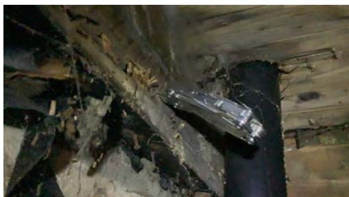
Råte i gulvbjelke.
