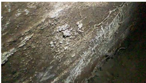
Eksempel på saltutslag på grunnmur.
