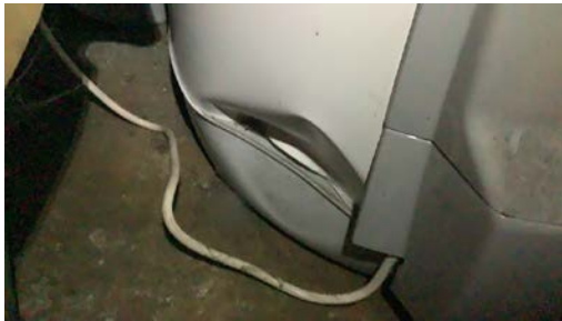
Bulk i varmtvannstank.
