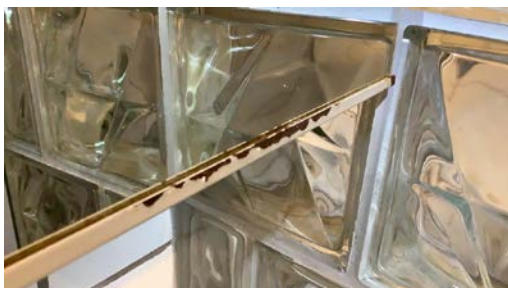
Rustdannelser på speilskap.
