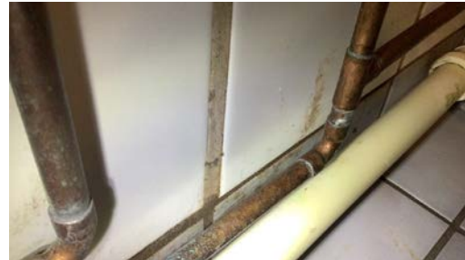
Sprang mellom veggfliser.
