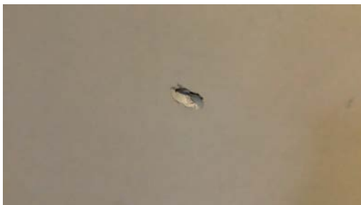
Slitasje på overskapsdør.
