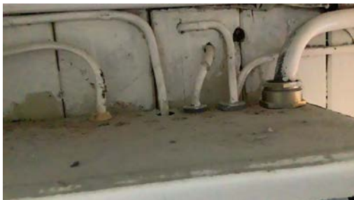
Utettet innføring i sikringsskap.
