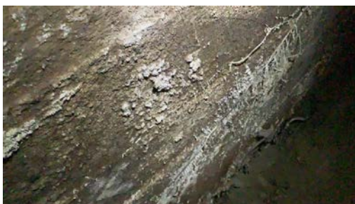
Eksempel på saltutslag på grunnmur.
