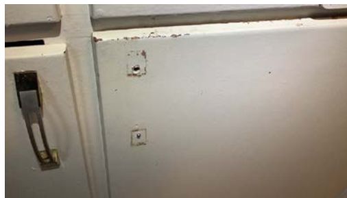
Slitasje på skapdør og manglende håndtak.
