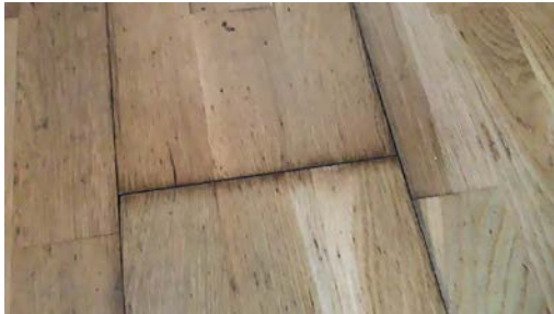
Fuktskadet parkettgolv i gang.
