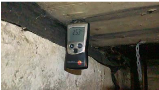
Det måles skadelig fuktinnhold i himling.
