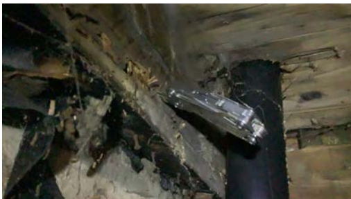
Råte i gulvbjelke.
