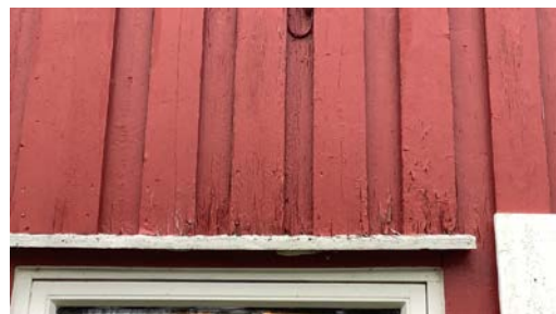
Eksempel på spredte råteskader.
