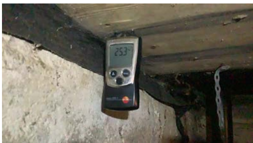
Det måles skadelig fuktinnhold i himling.
