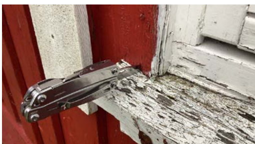
Omramming er ført helt ned til vannbrett og dette har ført til råteskader.
