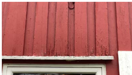
Eksempel på spredte råteskader.
