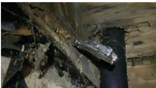
Råte i gulvbjelke.
