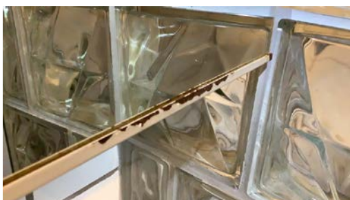
Rustdannelser på speilskap.
