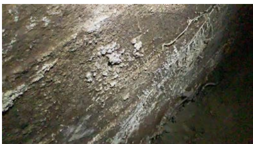
Eksempel på saltutslag på grunnmur.
