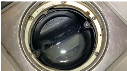
Plastsluk, og det er synlig smøremembran under slukets klemring.
