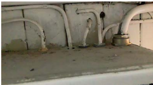
Utettet innføring i sikringsskap.
