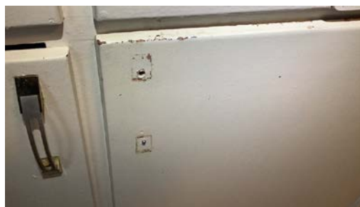
Slitasje på skapdør og manglende håndtak.
