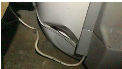
Bulk i varmtvannstank.
