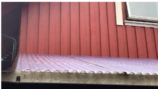
Det er ikke montert overgangsbeslag mellom yttervegg og tak.
