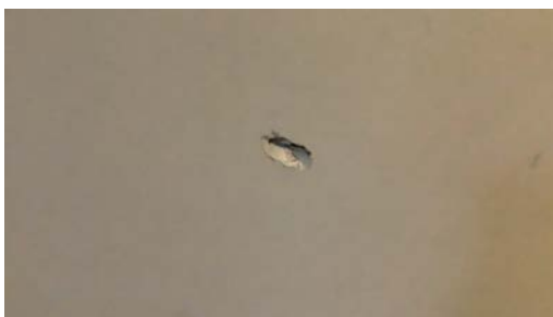
Slitasje på overskapsdør.
