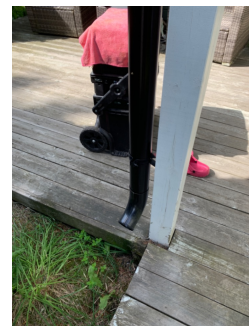
Nedløpsrør bør føres med rør vekk fra boligen
