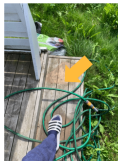
Trappen svikter i dette hjørne (kun utført stikk kontroll)
