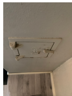
Mangler ubrennbart materiale under sotluke
