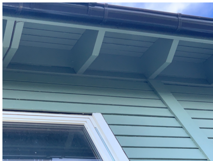
Det mangler lufting av takkonstruksjonen
