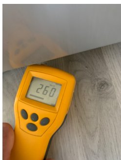
Påvist høye fuktsøkverdier foran/ ved kjøleskap
