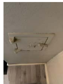
Mangler ubrennbart materiale under sotluke
