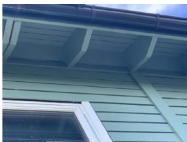
Det mangler lufting av takkonstruksjonen
