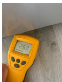
Påvist høye fuktsøkverdier foran/ ved kjøleskap
