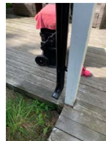
Nedløpsrør bør føres med rør vekk fra boligen
