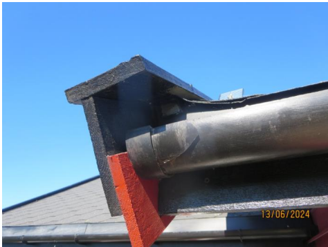
Bilde viser at takrenne har sprukket i ende ut mot vindski
