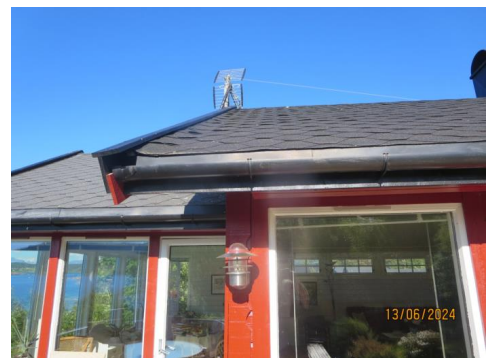
Bilde viser løse soner til papp shingelen ut mot vindski
