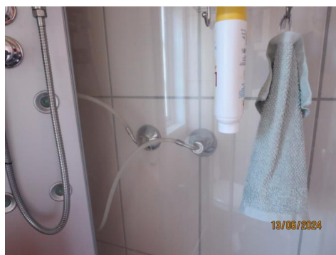
Vann tilkobling for dusj kabinettet i plast
