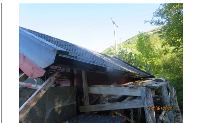
Takrenne på grill husets ene side har mangler, dels defekt. Materialer mot vegg hindrer lufting til konstruksjonen, fare for fukt, muggdannelser.
