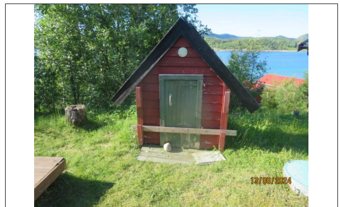
Bilde tatt mot røyk huset etablert på østside. Behov for vedlikehold.
