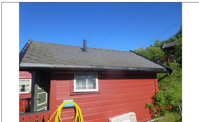
Bilde viser groing på tak til annekset. Ikke luftede deksel over soil rør fra ute- doet Utbedring av takrenne anbefales, slitt kledning, vedlikehold trengs
