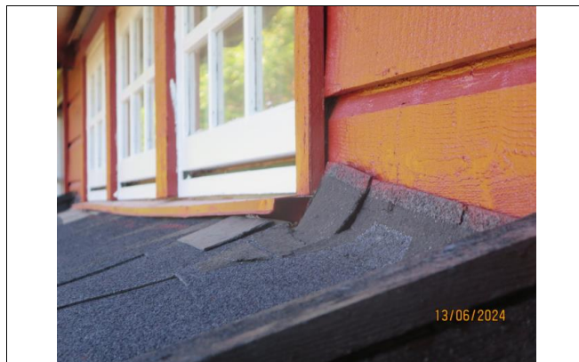
Bilde viser åpning i tak mot hoved hytta fra utvendige uisolerte bod. Må ordnes Mosegroing på taket
