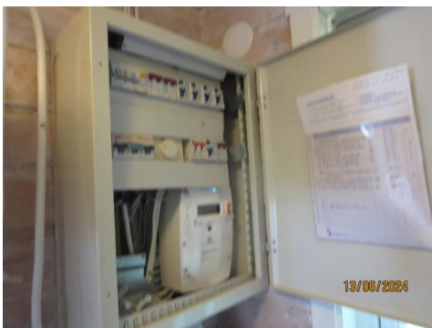
Bilde tatt mot sikringsskapet etablert i bod, tekn. rom m/automatsikringer, kurs fortegnelse.
