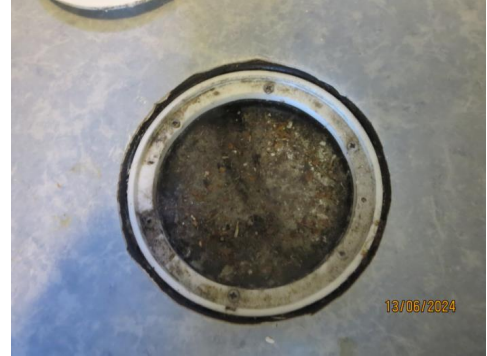
Sluk på bod, tekn. rom ikke rengjort, har ikke vært i bruk på lenge. Må rengjøres.
