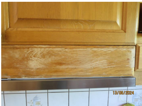
Bilde tatt mot del av fronter til innredningen, er fra byggeår, er noe slitt enkelte steder til fronter.
