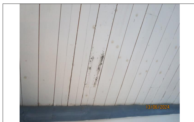
Bilde viser mugg dannelser i tak på grill huset, har manglende lufting. det er fukt, muggdannelser til deler av konstruksjonen også.
