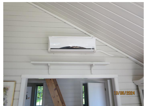
Bilde tatt mot utkast til varmepumpe etablert på vegg til åpent rom stue, kjøkken gangs sone
