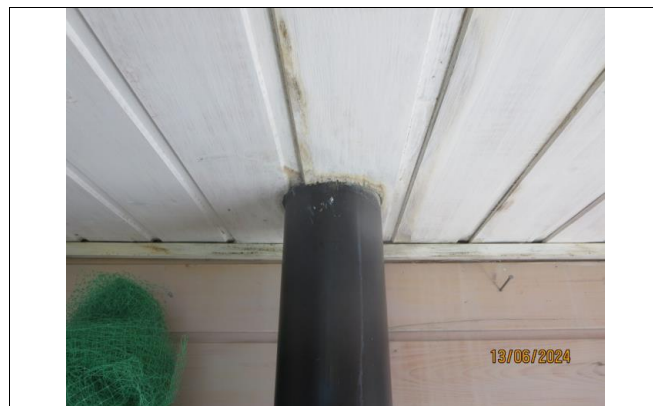
Fukt merker i tak på ute- do annekset.
