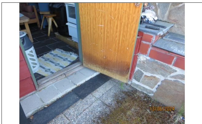
Slitt, skadet dør til grill huset, tar henger, vanskelig å lukke
