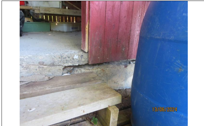
Skade, glippe, åpning til betongdekke naust.
