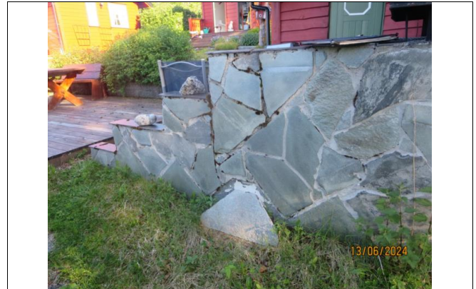
Bilde viser løse skifer heller til støttemur ved grillplass
