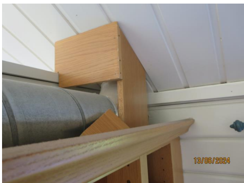
Bilde tatt mot avtrekk spiro kanal fra ventilator og ut. Dels åpen spiro. Ikke innkasset.
