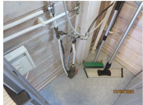
Bilde viser åpent anlegg til rør føringer. Inntak vann kommer opp via gulvet m/ videre fordelinger gjennom vegg til badet.
