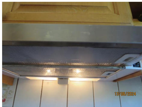
Bilde tatt mot kjøkken ventilator etablert over komfyr m/ komfyr vakt, avtrekk ut over tak.
