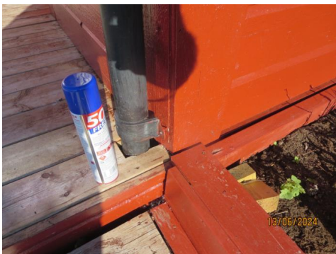
Feste klemme til nedløp løs, anbefalt festet bedre, hjørne til inngangs sone.
