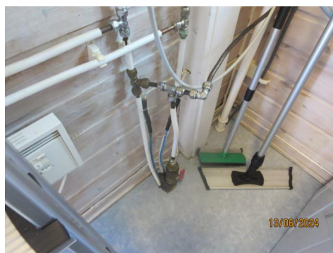
Bilde viser røropplegg til vann, hvor hoved inntak kommer opp gjennom gulvet.
